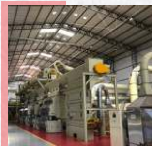
Sala de Máquinas
